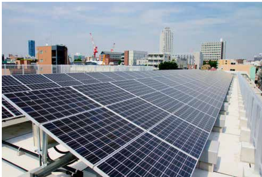
豊島区立学校の屋上に設置された太陽光パネル
