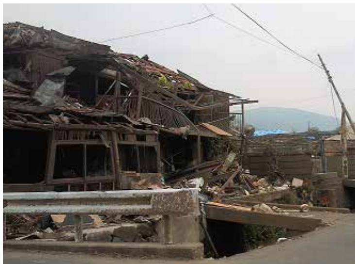
これまでは遠い外国の出来事とみられていた竜巻 2012年つくば市で発生した竜巻による家屋被害
