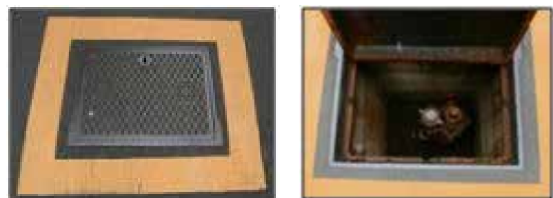
道路の消火栓の位置は東京消防庁ホームページの「東京消防庁マップ」で確認することができます
