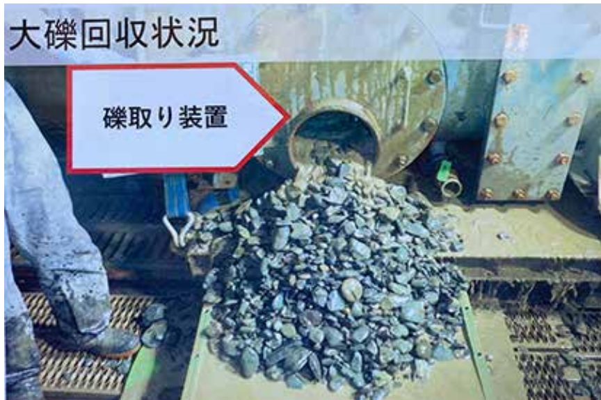
工事を遅らせる原因となった大礫 (下水道局提供写真)
